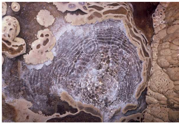
FIG. 4b – Concrétion dans le tunnel de Godarville (photo J. Depasse).
